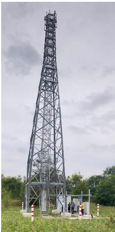
Am Funkmast in Möhlau nahm die BSZ netz GmbH eine neue Strom-Netzersetzanlage in Betrieb.
